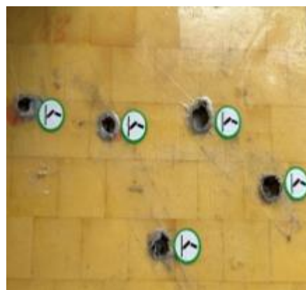
Obr. 4.12 – Šíření trhlin - segmentovaná keramická deska se skelnou kompozitní vrstvou [47]
